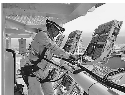
写真1 施設の様々な電気設備の総合メンテナンス
